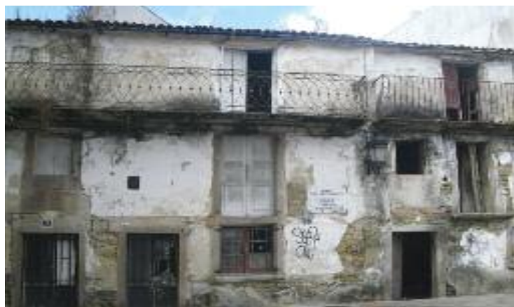
As casas da Praza das Coles presentan un estado deplorable
