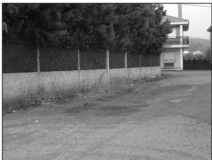
A rúa Boimorto, próxima ao pavillón, está en mal estado
