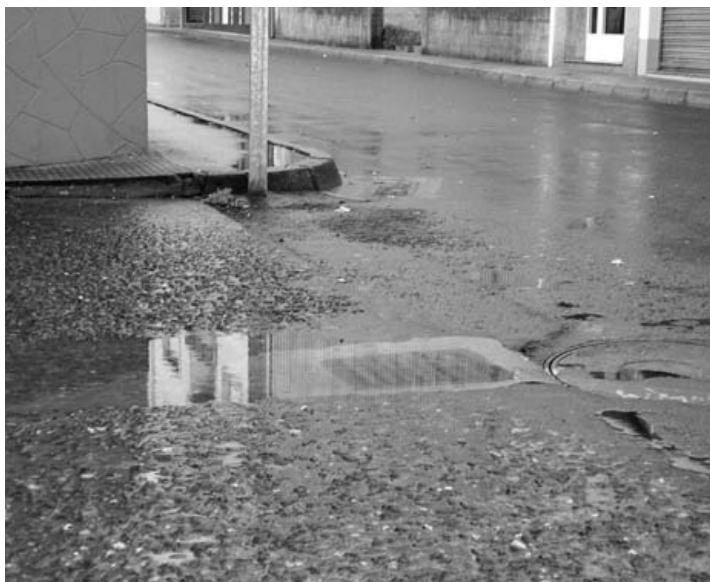
Varios sumidoiros da vila non absorven os residuos
