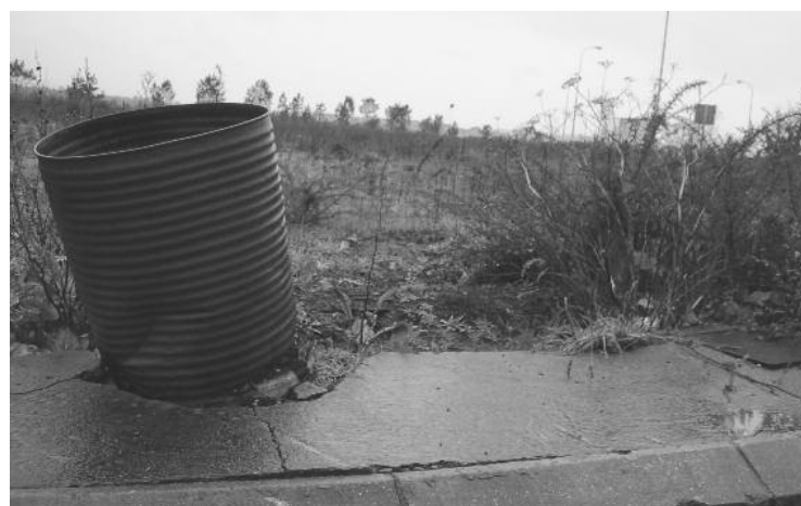
Algún dos sumidoiros está tapado con elementos inaxeitados
