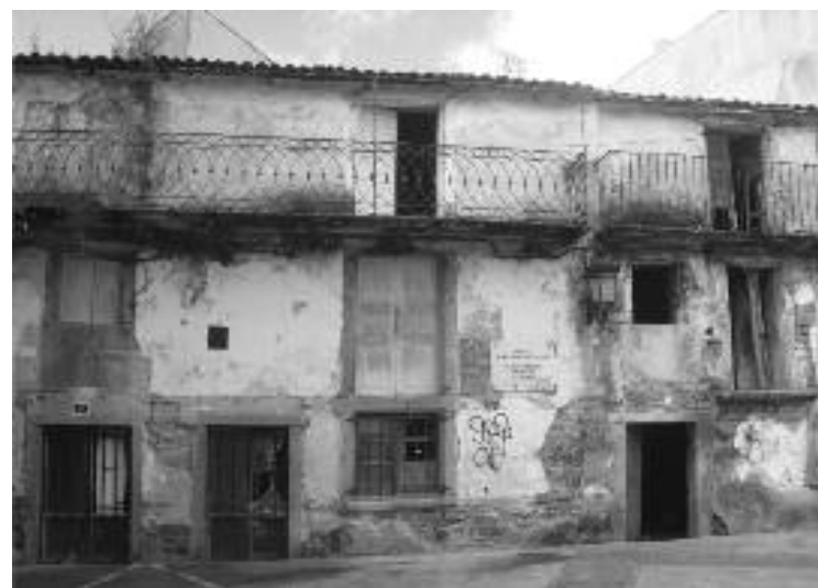
Os veciños temen que se produza un derrubamento
