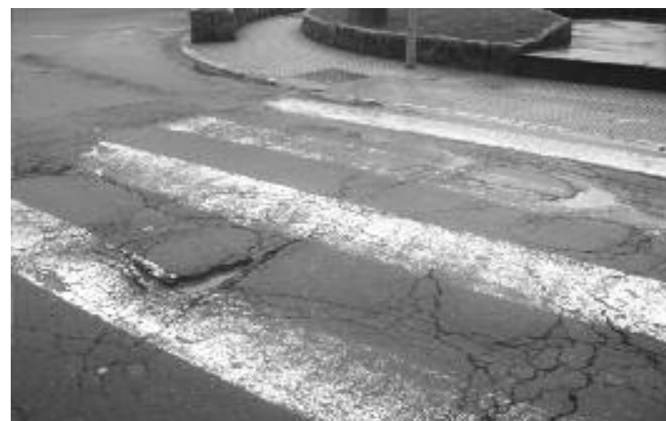
Estado do firme de AC-840 en pleno centro de Melide
