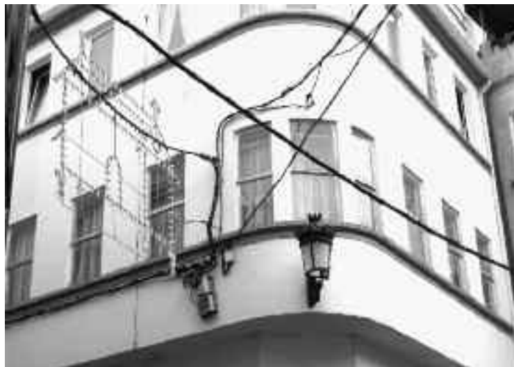
Profusión de cables na Rúa Travesa
