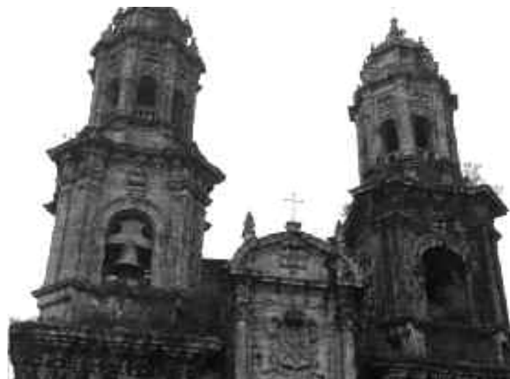
Estado actual do campanario da igrexa de Santa María de Sobrado
