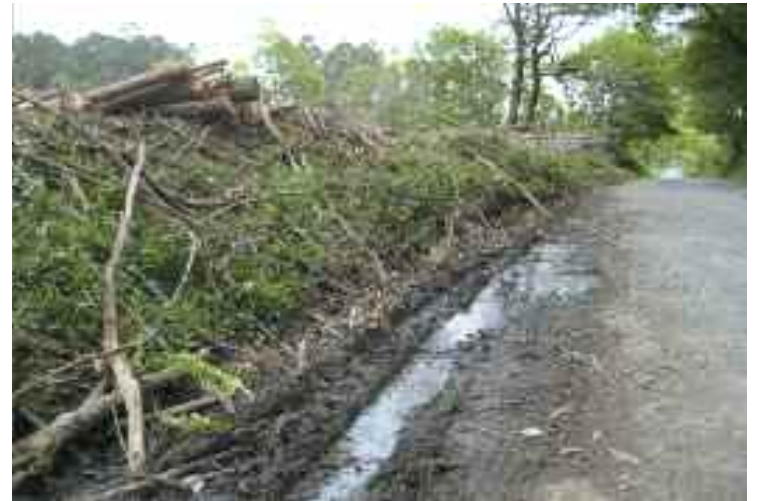
Pista e cunetas destruídas na aldea do Curutelo
