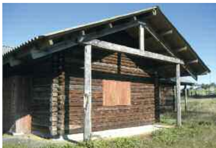
A estrutura do edificio, de madeira, está afectada pola couza
