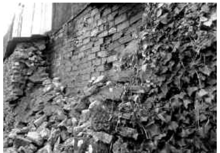
No cemiterio do Castelo viñéronse abaixo catro metros de muro
