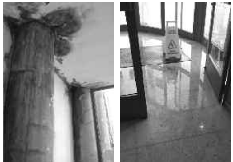
Humidade nos teitos e goteiras no chan do centro de saúde
