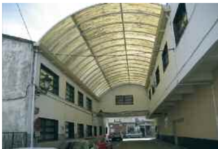
A cuberta está chea de furados provocados por unha sarabiada
