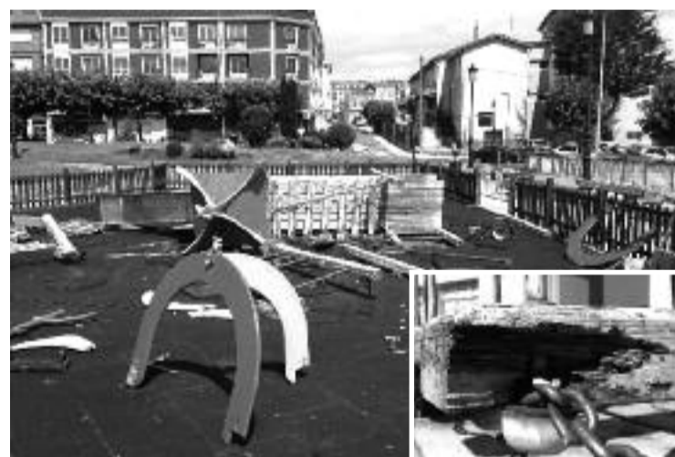
Proceso de retirada do mobiliario e detalle da madeira podre
